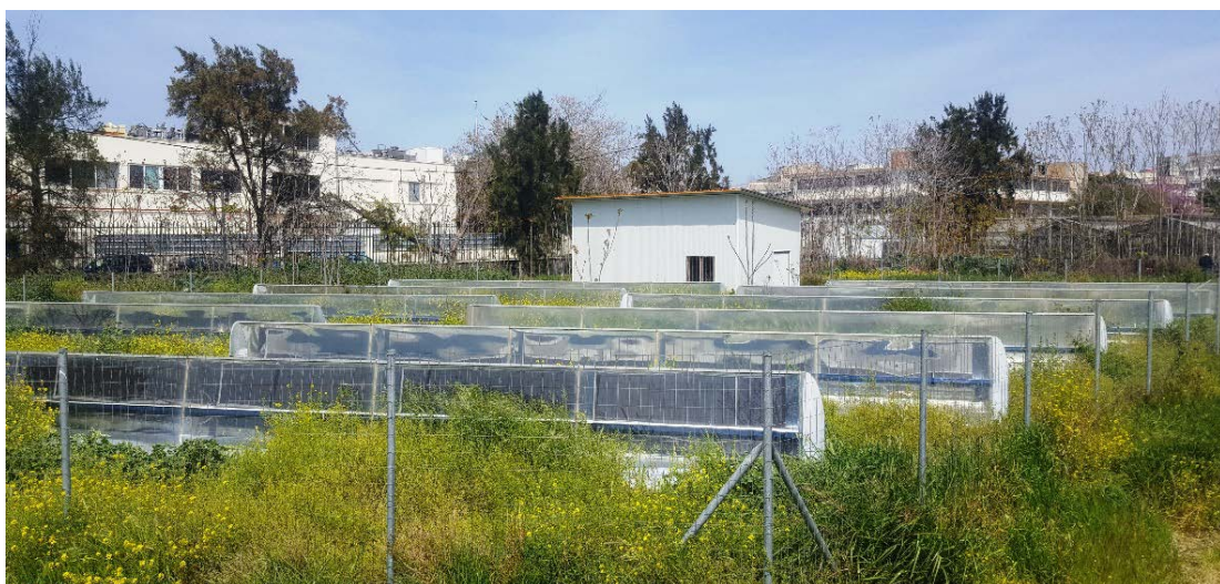
Συγκεντρωτικό φωτοβολταϊκό σύστημα 10 kWp.
