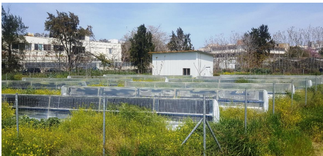
Συγκεντρωτικό φωτοβολταϊκό σύστημα 10 kWp.
